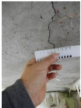
ÜBERBAU- FERTIGTEILUNTERSICHT SEITE UNTERSTROM DURCHGEHEND LÄNGS GERISSEN
