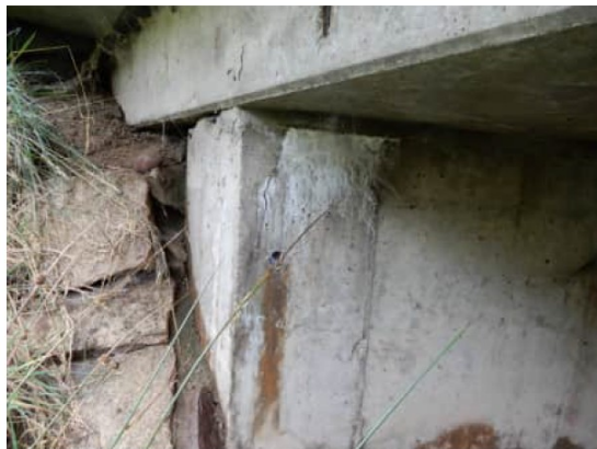
UNTERBAU- WIDERLAGER OBERSTROM LINKS BETONKANTE SCHRÄG GERISSEN
